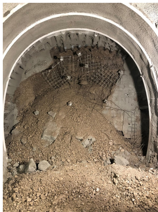
4 Ortsbrustinstabilität beim Vortrieb des Erkundungsstollens (späterer Sicherheitsstollen)
