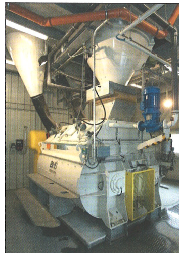
Bild 7: 3-m 3 -Zweiwellenzwangsmischer der Betonanlage in Bodio
