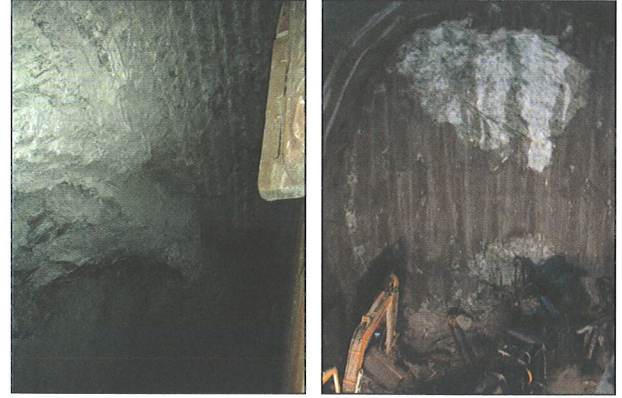
Bild 10: Auswirkungen der Blockigkeit Ortsbrust im TBM und SPV
