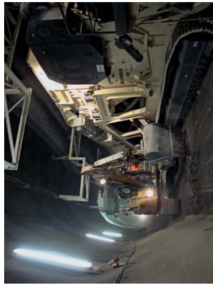
10 Teleskopierbare Ventilationsbühne für die optimale Frischluftzufuhr bis zur Ortsbrust und zur effizienten Spülung der Sprengschwaden (Ceneri-Basistunnel – Los Sigrino) Telescopic ventilation platform for optimal fresh air supply up to the heading face and for efficient suction ventilation of blasting fumes (Ceneri Base Tunnel – Sigrino section)
